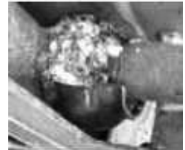
Corrosion galvanique sous le manchon plastique Galvanic corrosion under the plastic sleeve.
